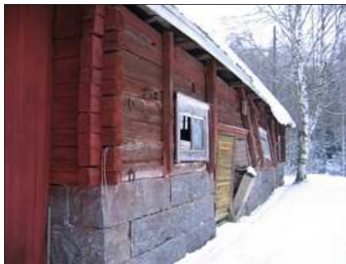
Entisen navetan seinät ovat osittain huonossa kunnossa. (Susanne Öst 12.02.2007)
